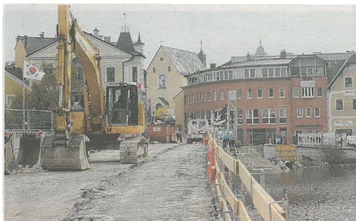
Die Traunbrückenarbeiten haben bereits begonnen. Ab 26. November wird die Brücke per Ampelregelung zwei Monate lang in beiden Richtungen befahrbar sein.
